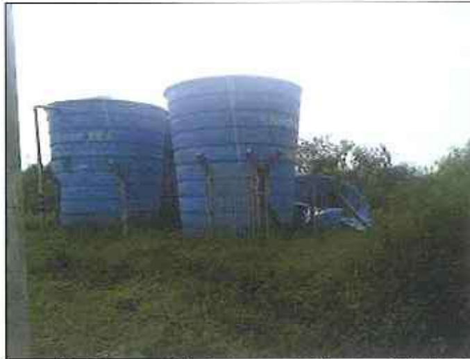
Figura 31: Reservatório Loteamento Flores – 20 m 3 cada
