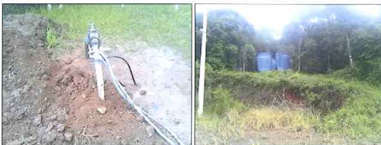
Figura 51: Poço Industrial / Campina Bela (à esquerda) e quatro reservatórios com capacidade de 25 m 3 cada (à direita)
