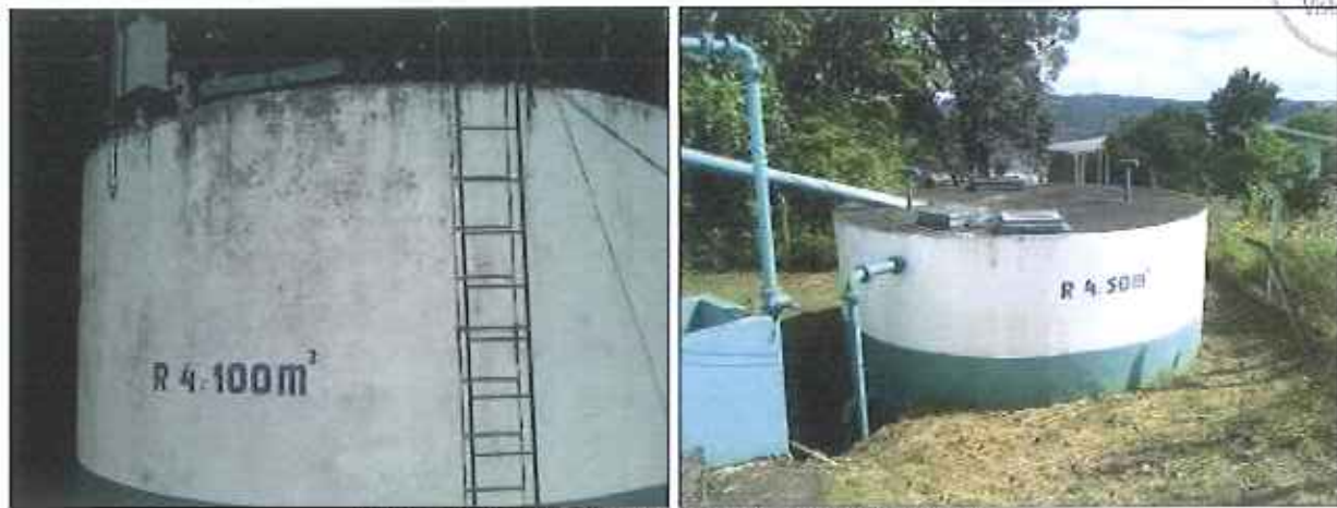
Figura 22: Reservatórios R04 – 100m³ e 50 m³
