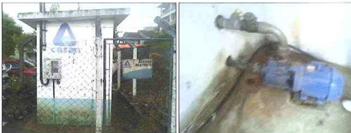
Figura 45: ERAT 3.2, com vazamento
