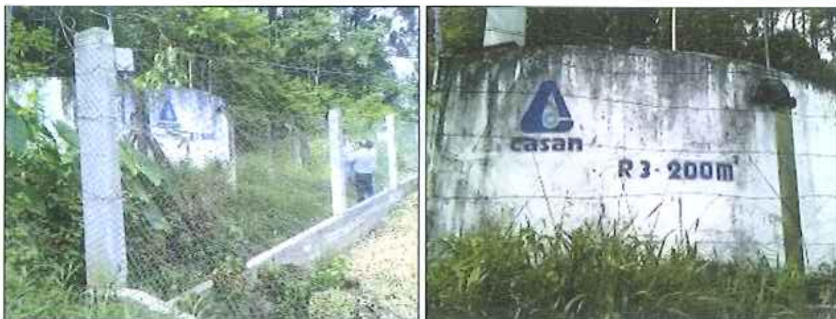
Figura 19: Reservatório R03 – 200 m 3
