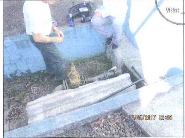
Figura 12: Imagem da coleta de água no Reservatório R2.2A.
