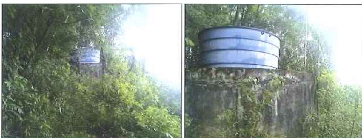
Figura 21: Reservatório R03.2 – 25 m 3
