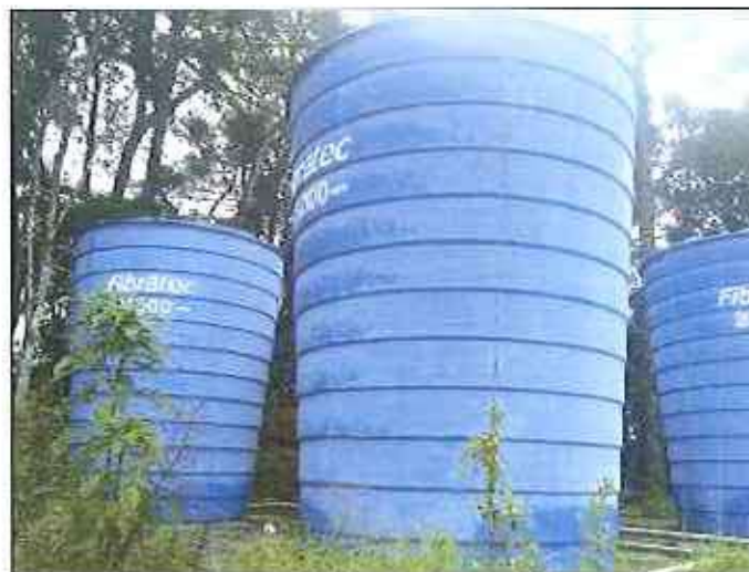
Figura 33: Reservatório Loteamento Menegola – 25 m 3
