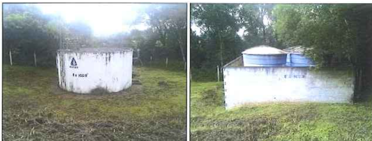
Figura 30: Reservatórios R06 – 100 m 3 + 25 m 3 cada
