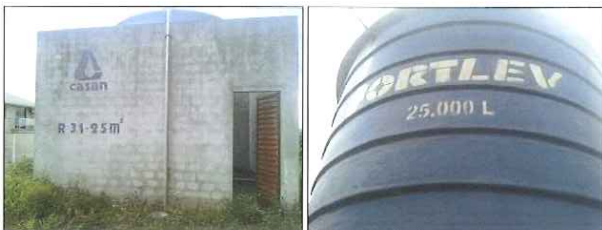
Figura 20: Reservatório R03.1 – 25 m 3
